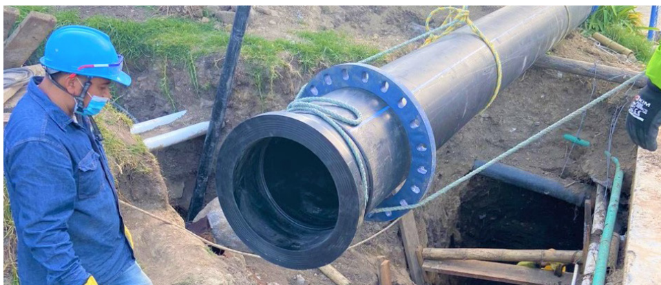
Contar con sistema de acueducto y alcantarillado moderno garantiza que el agua en Pasto se pueda consumir directamente de la llave.
