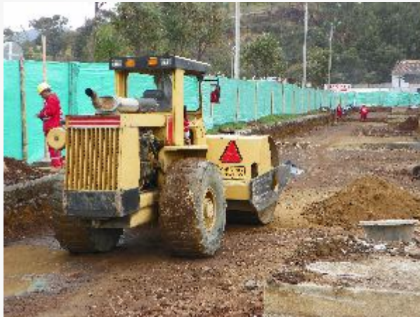
Pavimentación una calzada avenida Chile (Cra 9) entre avenida Idema (Calle 18a) y Calle 22
