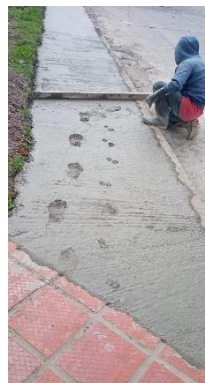
DAÑOS OCASIONADOS POR COMUNIDAD DURANTE FRAGUADO DE CONCRETO
