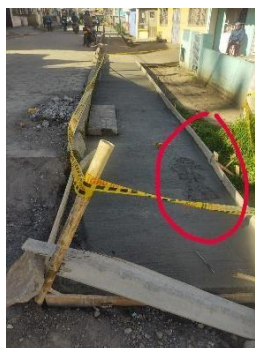
DAÑOS OCASIONADOS POR COMUNIDAD DURANTE FRAGUADO DE CONCRETO
